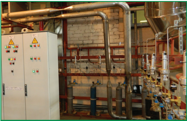
Рис. 6. Криогенный трубопровод на производстве «Арселор Миттал», (г. Темиртау, Казахстан), сданный в эксплуатацию в 2012 г.
