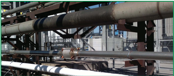
Рис. 5. Криогенный трубопровод на производстве «Арселор Миттал», (г. Темиртау, Казахстан), сданный в эксплуатацию в 2012 г.
